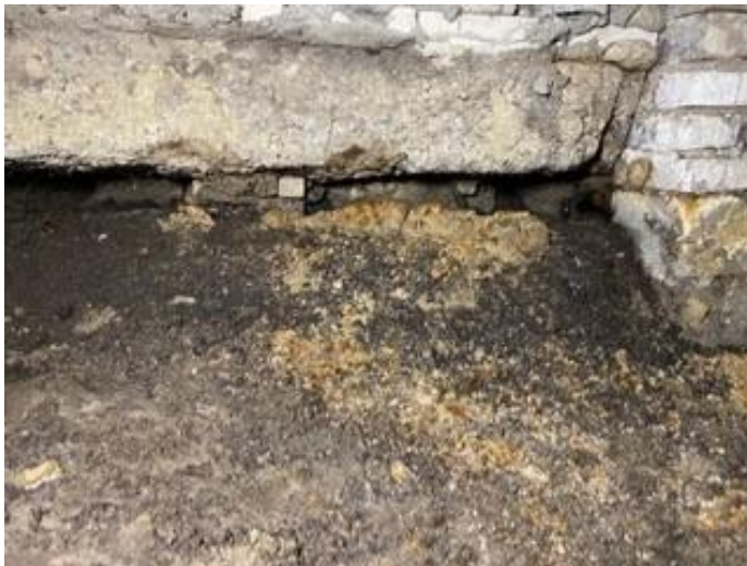
Figuur 6.4 Detailfoto genomen vanuit de kruipruimte waarbij aan de rechterzijde een poer is te zien en bovenin de horizontale ligger waar de muren van het huis op rusten. Onder de horizontale ligger is duidelijk een 'spleet' te zien tussen de legger en de vloer van de kruipruimte
