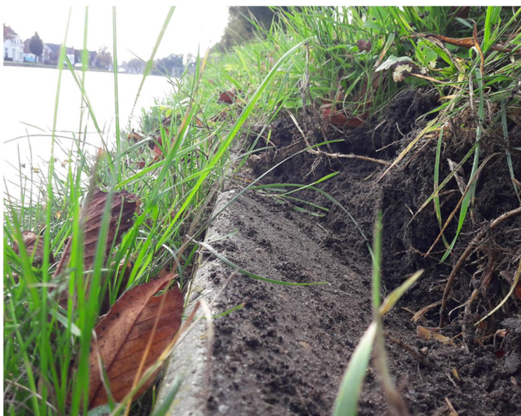
Figuur 6.2 Scheefstand van betonnen damwand langs het kanaal
