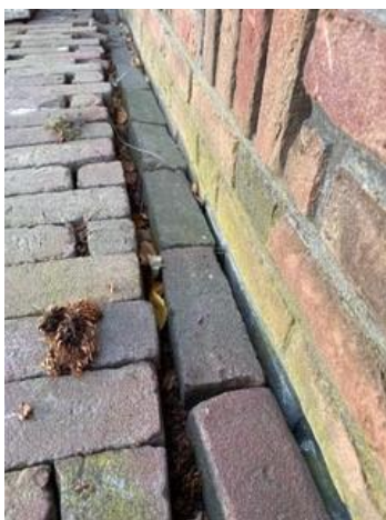
Figuur 6.5 Verzakkingen langs de gevel van hetzelfde pand waar inklink van het veen onder de kruipruimte is geconstateerd
